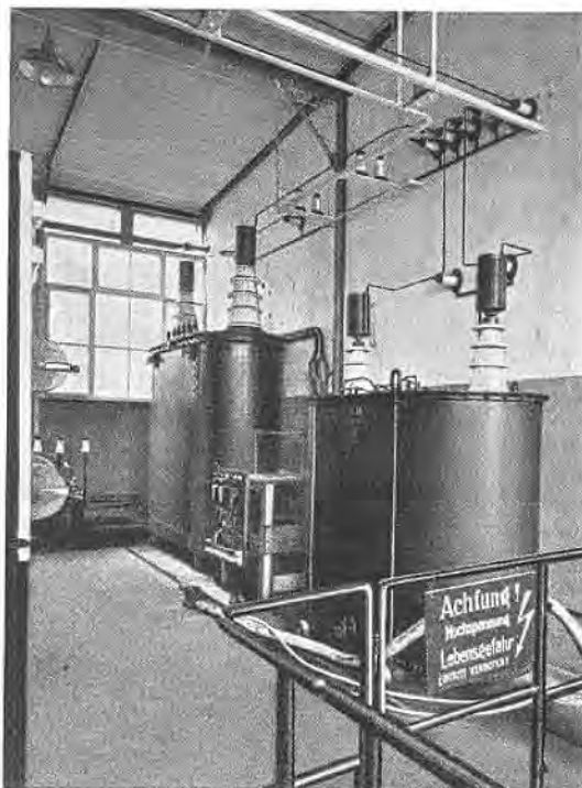
Bild 93. Versuchs- und Prüfanlage für Wasserkühlröhren im neuen Telefunken-Laboratorium, Wernerwerk, Siemensstadt: Die beiden großen Hochspannungstransformatoren. Sie liefern in Verbindung mit Ventilen bis zu etwa 20000 Volt Gleichspannung für die Anodenstromzufuhr bei Leistungen bis über 100 Kilowatt.
